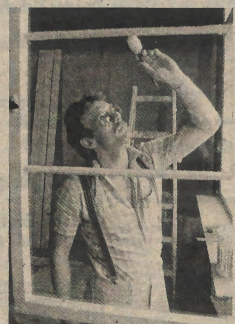
Kollege Olaf Endert, Mitglied der Malerbrigade „Heinrich Zille“ bei letzten Arbeiten im Raum 2007 im Bauteil V. 14mal verteidigte das Kollektiv den Staatstitel. 17 Kollegen gehören dazu. Fotos: Knobloch
