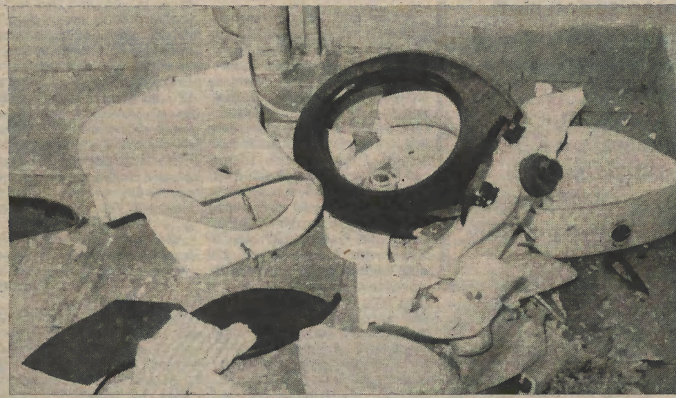
Dieses Bild sinnloser Zerstörungswut bot sich den Kollegen aus IM 6, Instandhaltung, als sie in der zweiten Juniwoche aufgefordert wurden, die Herrentoilette in der 4. Etage des Hauptproduktionsgebäudes des Farbbildröhrenwerkes zu reparieren. Wir möchten hinzufügen, daß wir die Ausmaße der Verunreinigung und Zerstörung auf einem weiteren Foto festgehalten haben, das wir aber den Lesern nicht zumuten wollen. Der Standpunkt der Kollegen aus IM 6 zu der Demolierung: „Dafür haben wir kein Verständnis. Das kann man uns nicht zumuten. Wir sehen unsere Bemühungen zur Verbesserung der Arbeits- und Lebensbedingungen, wozu auch die Installation von Sanitäranlagen gehört, mißachtet.“ (Inzwischen haben wir erfahren, daß die Verunreinigungen in der entsprechenden Toilette beseitigt wurden. — die Red.)
