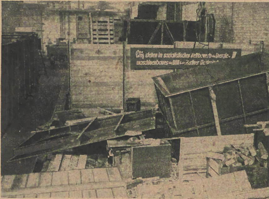
Unser Bild zeigt die Unfallstelle. Wo soll hier noch ein Kollege beiseite springen können. Unfälle verhüten ist besser als Unfälle vergüten.
