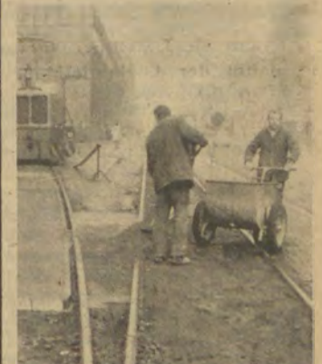
Kurzfristig besserten Kollegen des T-Bereiches in der vorletzten Woche schadhafte Stellen an und zwischen den Gleisen der Werkbahn aus.
