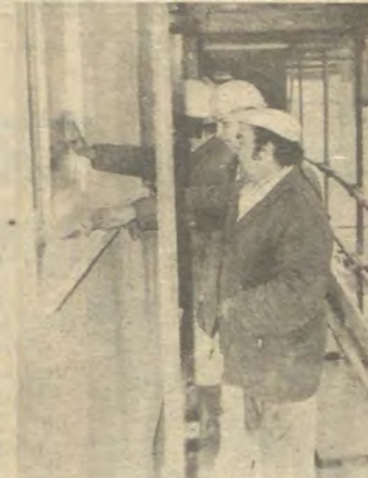
Eine Ausbildungsrichtung im TRO sind die Ausbaumaure. Auf unserem Foto Lehrfacharbeiter Harry Vahl mit Lehrlingen bei Restaurarbeiten am Anbau Halle 100.
