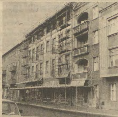
Eingerüstet ist das Gebäude des Union-Sporthauses in der Wilhelminenhofstraße. Hier sind Dachreparaturen vorgesehen.
