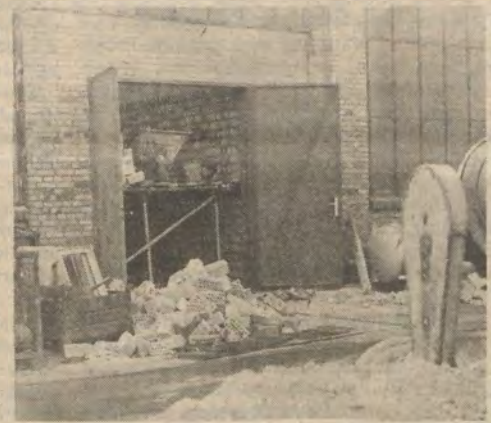
Es tut sich was an der Tor-schleuse zur Halle 113. Kollegen der Bauabteilung sind hier am Werk, sorgen dafür, daß die Schalterbauer zukünftig nicht mehr der ständigen Zugluft ausgesetzt sind. Wir kritisierten diesen Zustand im „TRAFO“ Nr. 38.
