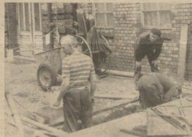
Auch die Rohrleger des Bereiches GA konnten ihre Aufgaben und Wettbewerbsverpflichtungen zu den Zwischenverteidigungen erfüllen.
