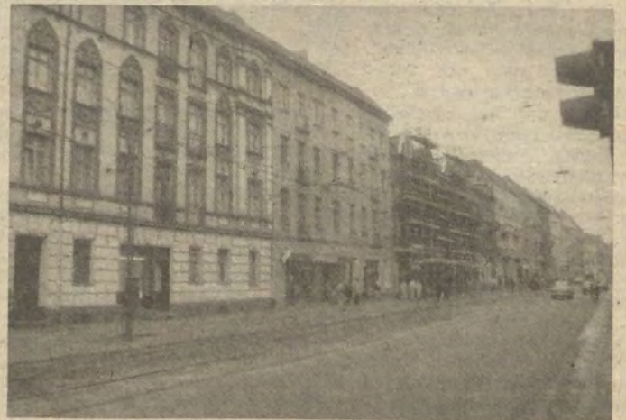
Rekonstruktion und Modernisierung in der Edisonstraße: viele Geschäfte erhielten ein modernes Gesicht, eröffneten neu.
