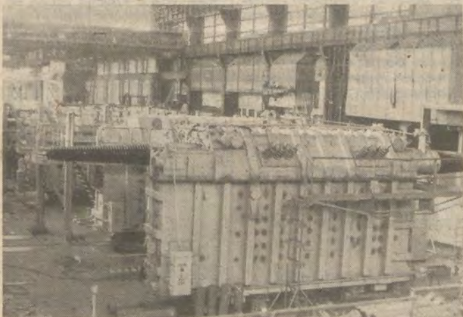
Blick in die Endmontage des Großtrafobaus. Hier wird derzeit der 125 MVA-Trafo für die Prüfung vorbereitet.
