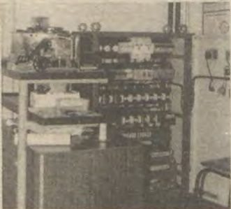
Der neue Schaltschrank.
