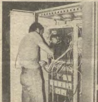
Jörg am Schaltschrank. Defekte findet man nicht auf Anhieb.
