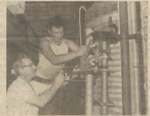
Kollegen der Schaltbrigade des Transformatorabbaus. Bei den Plandiskussionen dieses Bereiches ging es um die Aufgaben in den verbleibenden Monaten und für das nächste Jahr.
