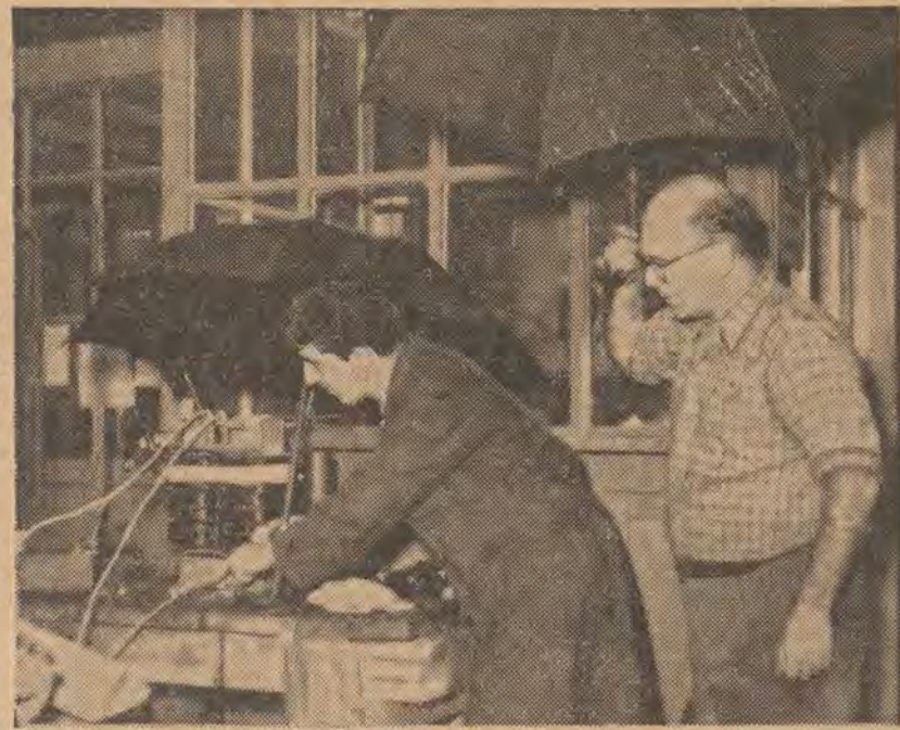
Mit solchen und anderen Mitteln suchten die Kollegen des Prüffeldes Mtr die empfindlichen und wertvollen Geräte vor dem eindringenden Wasser zu schützen. Der elektrische Prüfgenerator 30 kVA fiel für einige Tage aus, da seine Windungen naß wurden. Hier sollte unsere Bauabteilung Sofortmaßnahmen ergreifen, daß sich solche Situationen bei Unwetter nicht wiederholen
