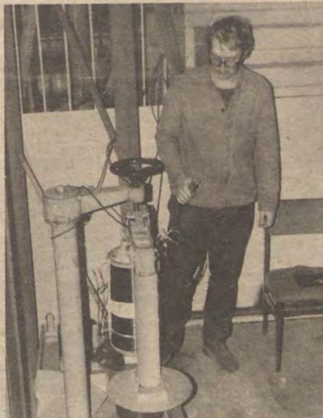
Neu im Mitteltrafobau ist das Vorprüffeld. Es gehört zum Jugendobjekt „Produktion der 50-kVA-Transformatoren“. Hier wird das Aktivteil des Trafos einer Prüfung unterzogen.
